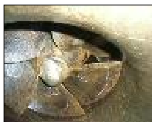
インペラの腐食 （和淤揚水機場）
