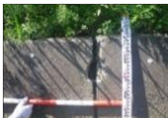
目地の欠損 （矢本幹線水路）
