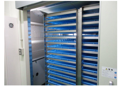
施設内部：干し芋低温乾燥室
