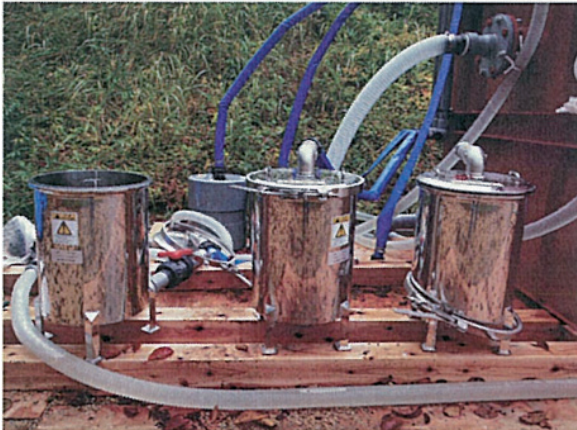
吸着除去設備（処理タンク）設置状況
