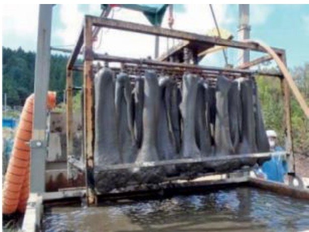
マルチドレーン真空脱水：濾過膜に吸着した濃縮泥
