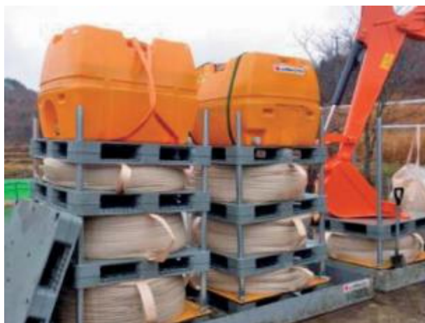
重力脱水：防水パンによる二次脱水
