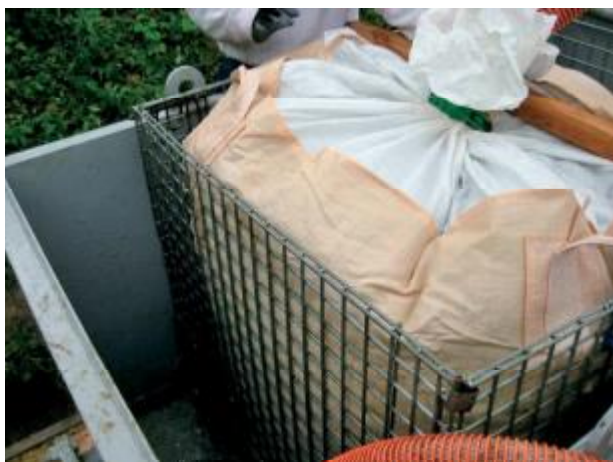
重力脱水：脱水カゴによる一次脱水
