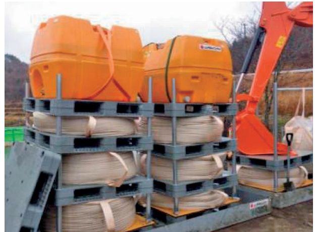
重力脱水：防水パンによる二次脱水
