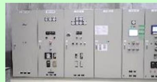
発電制御盤 (2階)
