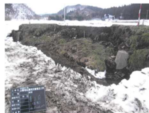
田の側面崩壊（施工前）
