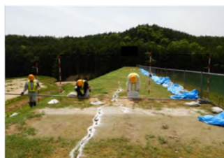
ため池の被災状況 施行前 （福島県新地町）
