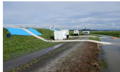
排水状況（中泊町 なかとまりまち ）
