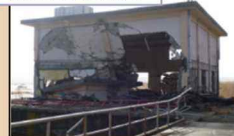
被災した排水機場
