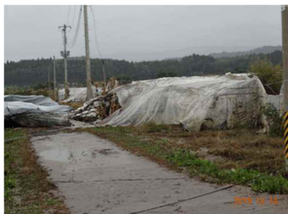
倒壊した農業用ハウス
