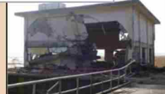
被災した排水機場
