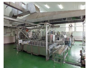
整備された加工設備
