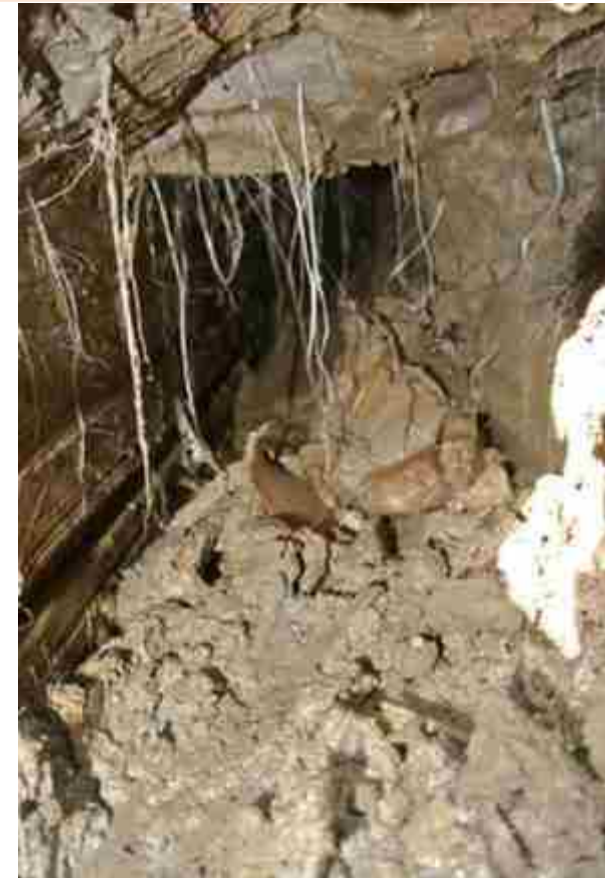
施工後 2 年空洞内
