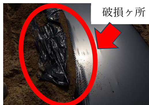
生分解性マルチ設置時の破損
