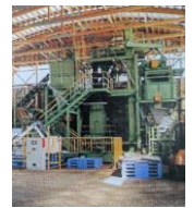
ペレット製造設備（現状）
