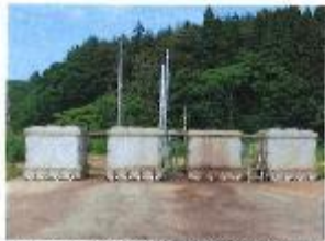
【バイオ炭を製造する密閉式炭化炉】 チップ化した林地残材を約1日かけて炭化後、炉内で約2日間かけて冷却する
