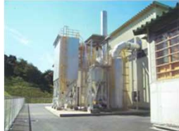
排ガス浄化設備
