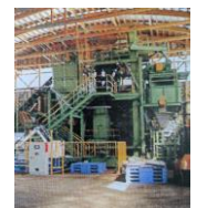
ペレット製造設備 (現状)
