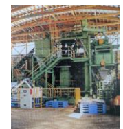
ペレット製造設備 (現状)
