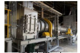
粉殻を用いた バイオ炭製造施設
