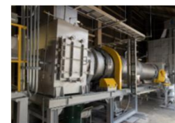
籾殻を用いた バイオ炭製造施設
