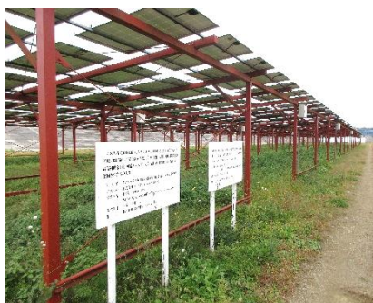
平成 31 年 2 月に設置した太陽光発電設備
