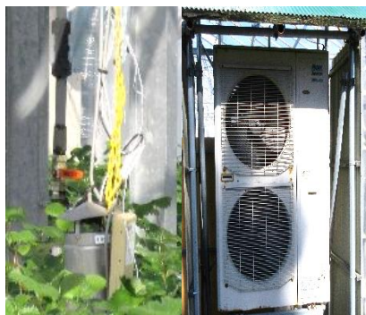
環境測定器(左)と室外機(右)
