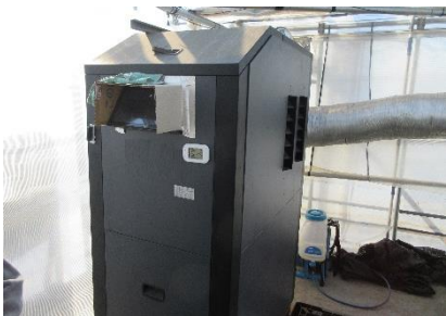
ペレットボイラー
