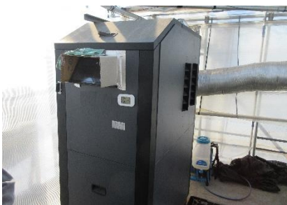
ペレットボイラー
