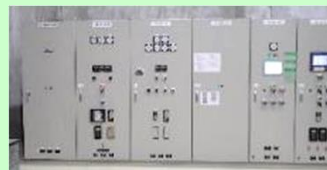
発電制御盤 (2階)
