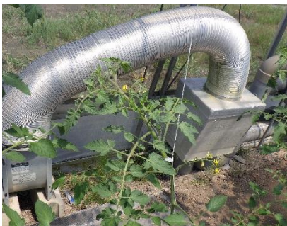
地中熱を供給する機械で地中の暖かい空気を取り入れる
