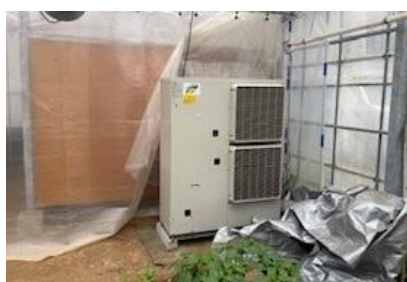
地下水利用熱交換器
