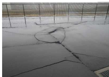
③ポンプ場場内舗装の被災状況
