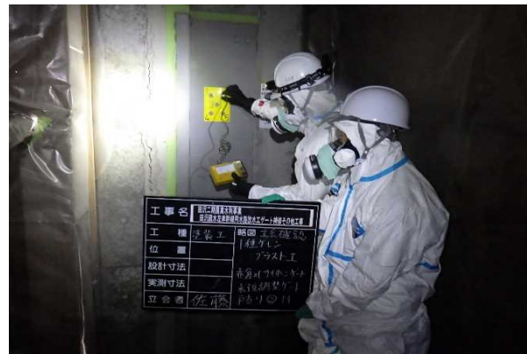
田沢疏水左岸幹線用水路放水工ゲート補修 その他工事 1種ケレンブラスト工確認
