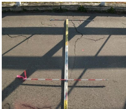
管理用道路の亀裂調査
