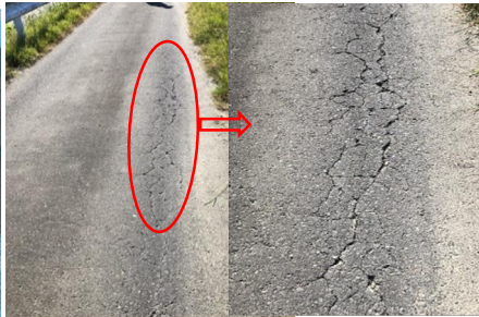
道路面の亀裂状況(写真②)
