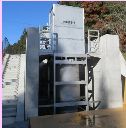
発電設備（正面） （上部（箱型）が発電機、下部（円筒形）が水車）
