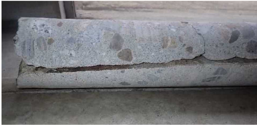
コンクリートコア（継目に隙間）
