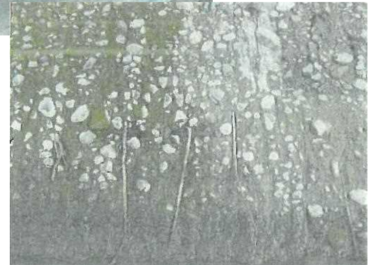
エプロンの摩耗状況 (鉄筋の露出)
