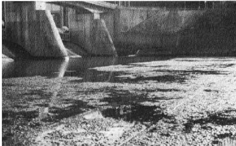
下流エプロンの劣化状況 (骨材の流出・欠損)
