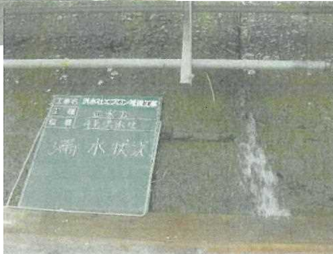
接合部からの漏水状況
