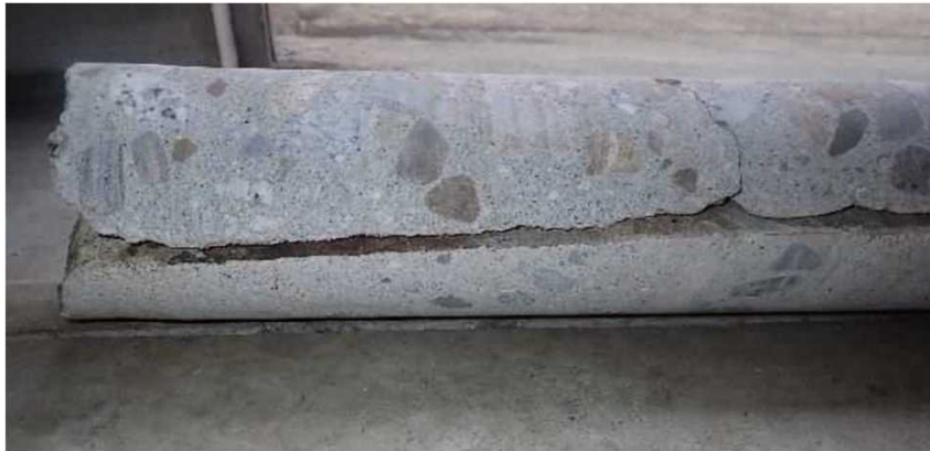
コンクリートコア（継目に隙間）
