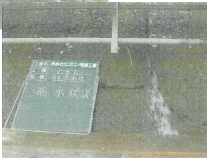
接合部からの漏水状況
