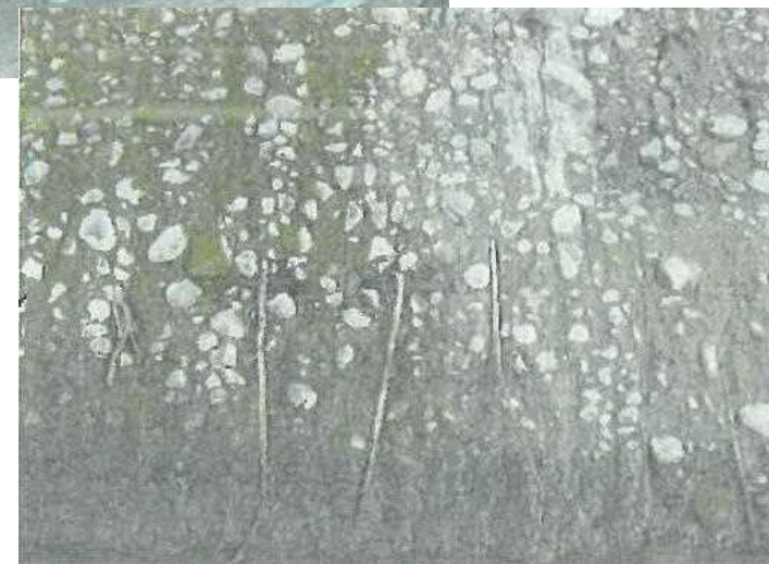
エプロンの摩耗状況 (鉄筋の露出)
