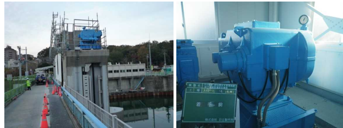
写真-開閉装置写真(施工時)
