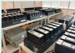
バッテリー保管・充電施設
