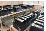
ドローンのバッテリー充電施設
