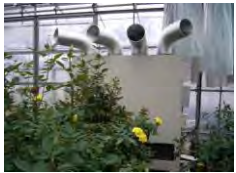
施設園芸用ヒートポンプ
