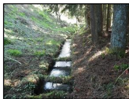
整備前(側壁の倒壊)
