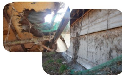
防鳥ネットの脱落と天井の穴
