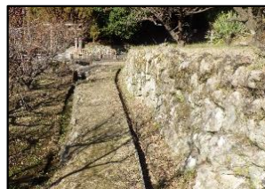
整備前(水路の老朽化)
