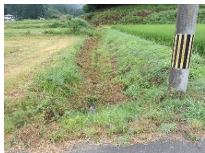
整備前(水路の老朽化)
