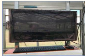
総合環境制御装置
