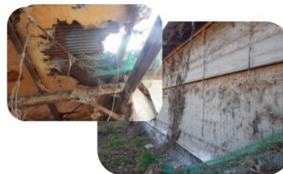
防鳥ネットの脱落と天井の穴
