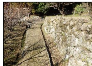
整備前(水路の老朽化)
