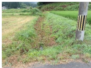
整備前(水路の老朽化)
