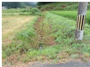
整備前(水路の老朽化)
