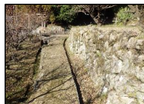
整備前(水路の老朽化)
