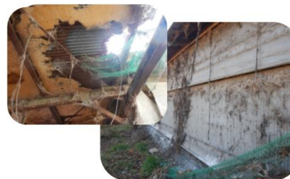
防鳥ネットの脱落と天井の穴
