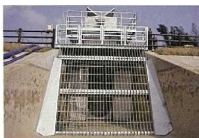
本事業で整備された除塵機
