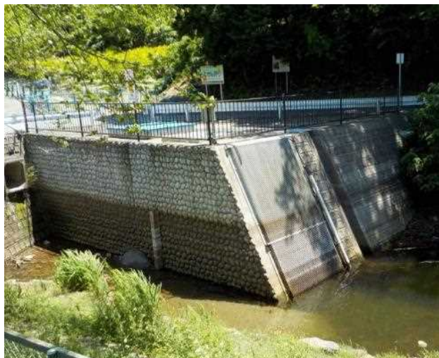
五桂池注・取水施設
