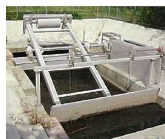
自動水位調整ゲート
