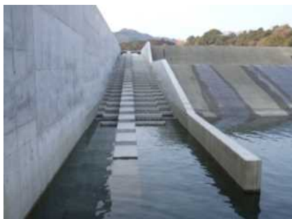
下流放流工（魚道）
