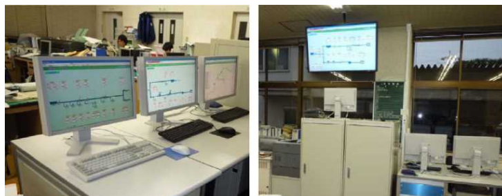
監視装置（3PWシステム）
