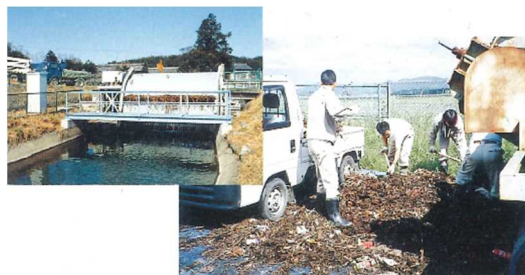
スクリーンのゴミ取り作業（事業実施前） 出典：東海農政局調べ
