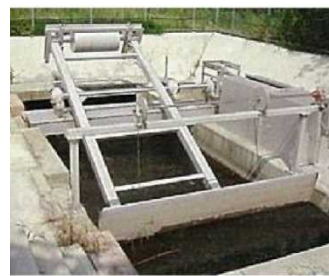
自動水位調整ゲート
