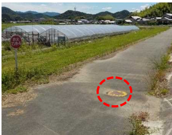
防火用マンホール（防火用水）
