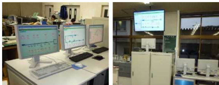
監視装置（3PWシステム）
