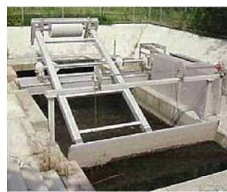
自動水位調整ゲート
