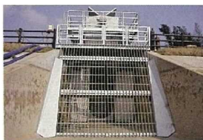
本事業で整備された除塵機
