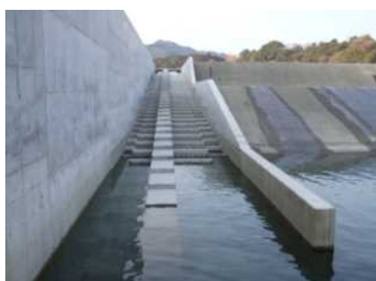
下流放流工（魚道）
