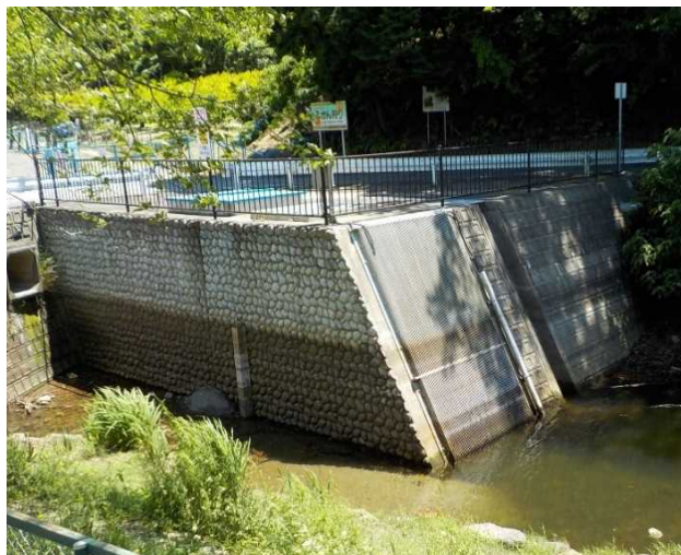
五桂池注・取水施設
