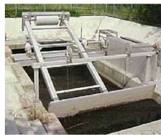
自動水位調整ゲート
