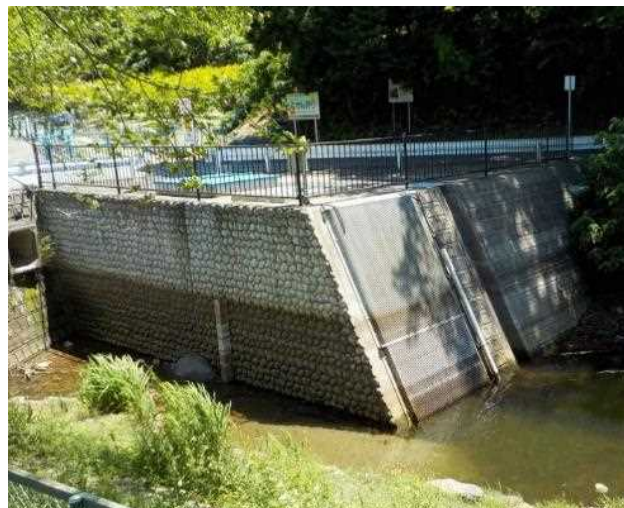
五桂池注・取水施設
