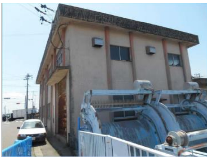
前野排水機場(廃止)
