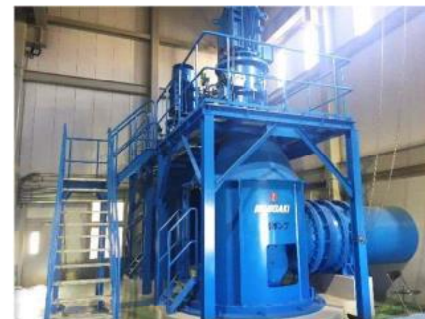
静里排水機場(ポンプ)
