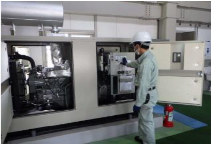
自家用発電機の点検
