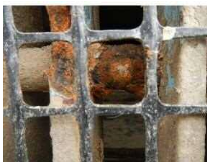
スクリーンパー発錆状況（安濃ダム）
