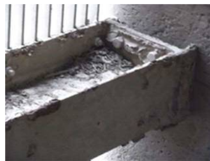
スクリーン受桁発錆状況（安濃ダム）
